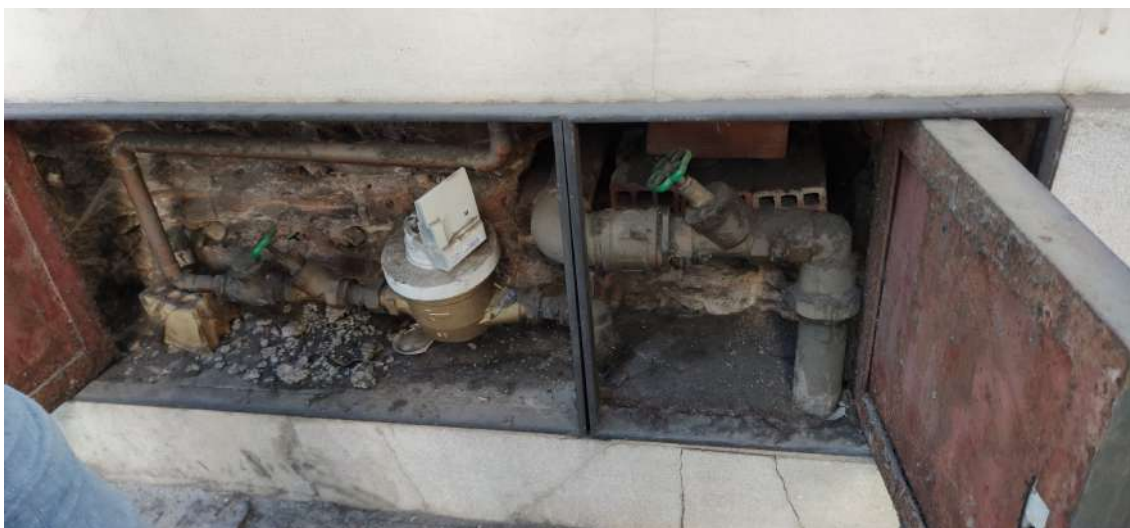
Acometidas de agua de consumo y PCI.
