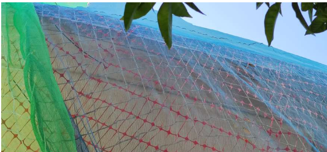
Fisura en cornisa de planta baja.
