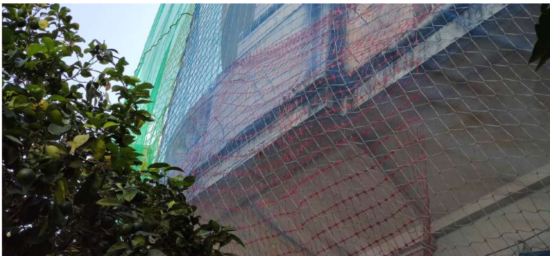
Fisura en cornisa de planta baja.
