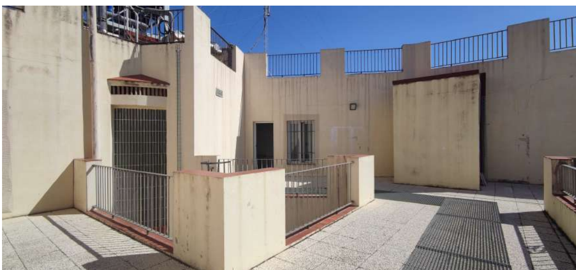
Azotea. Se aprecian fisuras puntuales en el revestimiento de fachada.
