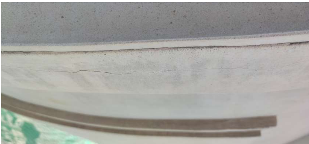
Fisuras puntuales en el revestimiento de la fachada principal.
