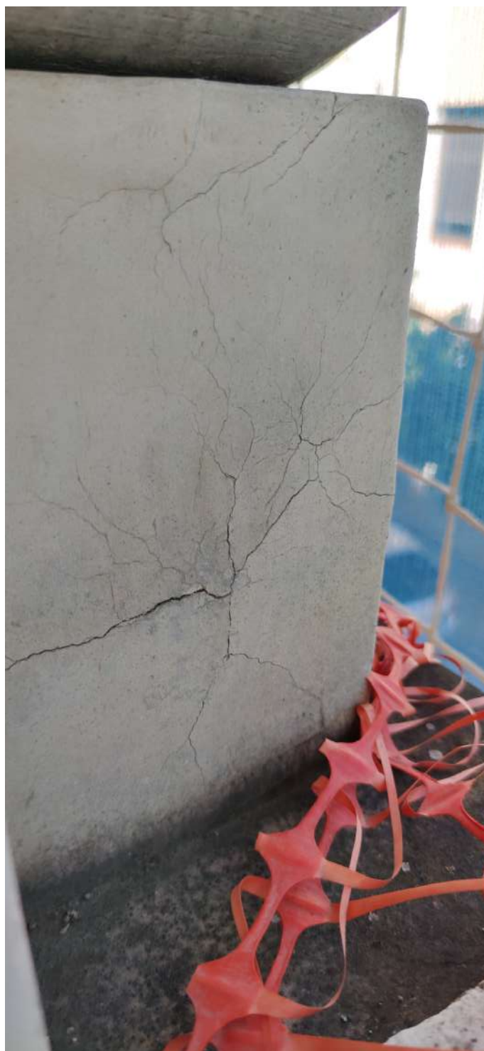
Fisuras puntuales en el revestimiento de la fachada principal.
