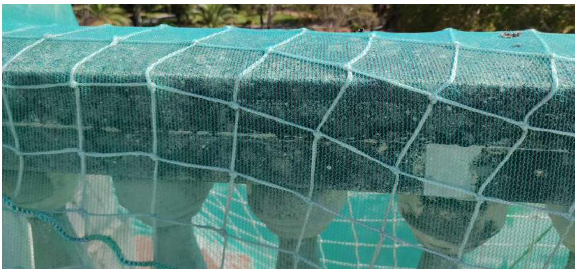
Balaustrada de azotea. Se aprecian manchas de moho y humedad generalizadas.
